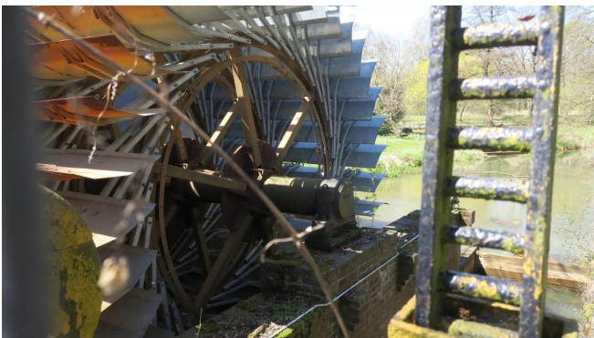
Wasserkraftanlage mit Hochpohlgenerator in Neumühl
